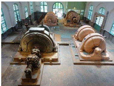
端出場水力発電所の内部
