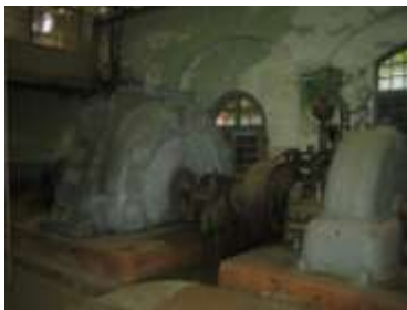
シーメンス社製発電機
